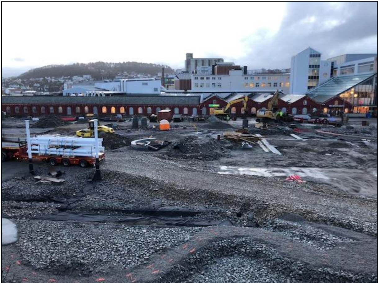
Nye Ruten i Sandnes sentrum under oppfylling med vaskede og sorterte gjenbruksmasser
